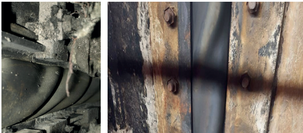
Figuur 4.5 / Plooivorming in de Botlektunnel (links) en Heinenoordtunnel (rechts).
