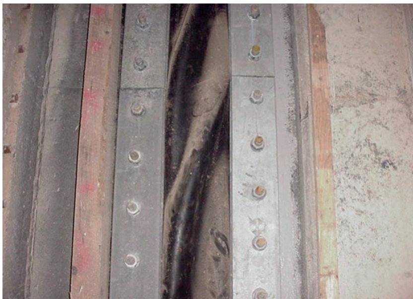
Figuur 1.2 / Plooiïng in omegaprofiel Tweede Beneluxtunnel. (Bron: Nebest)
